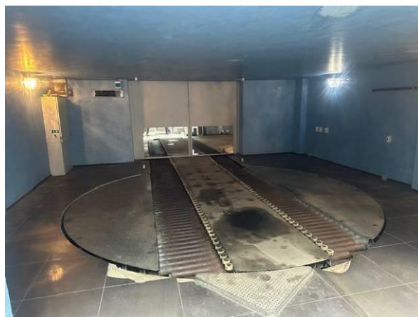
Pazemese stāvvietas telpa, no kuras automatizēti mašīnas tiek transportētas uz lietošanā esošo auto novietnes šūnu
